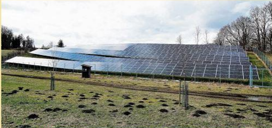
Die Freiflächen-Photovoltaik-Anlage in Föching neben der Autobahn ist eine der wenigen im Landkreis.
